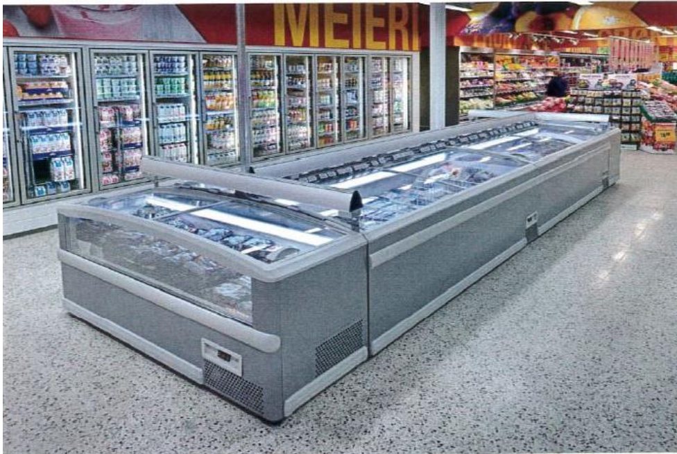
Moderne Kühlinseln zeichnen sich durch Wände mit hochwertigem und umweltfreundlichem Isoliermaterial und sparsame LED-Beleuchtung aus.
