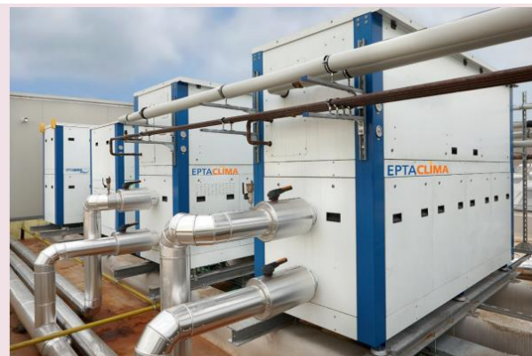
Epta konfiguriert und berechnet Kühlanlagen mitsamt Verrohrung.
