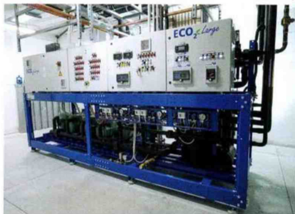
Un impianto Epta installato in un punto vendita Oasi di Gruppo Gabrielli a Perugia
