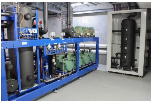
Centrale et FTE Epta
