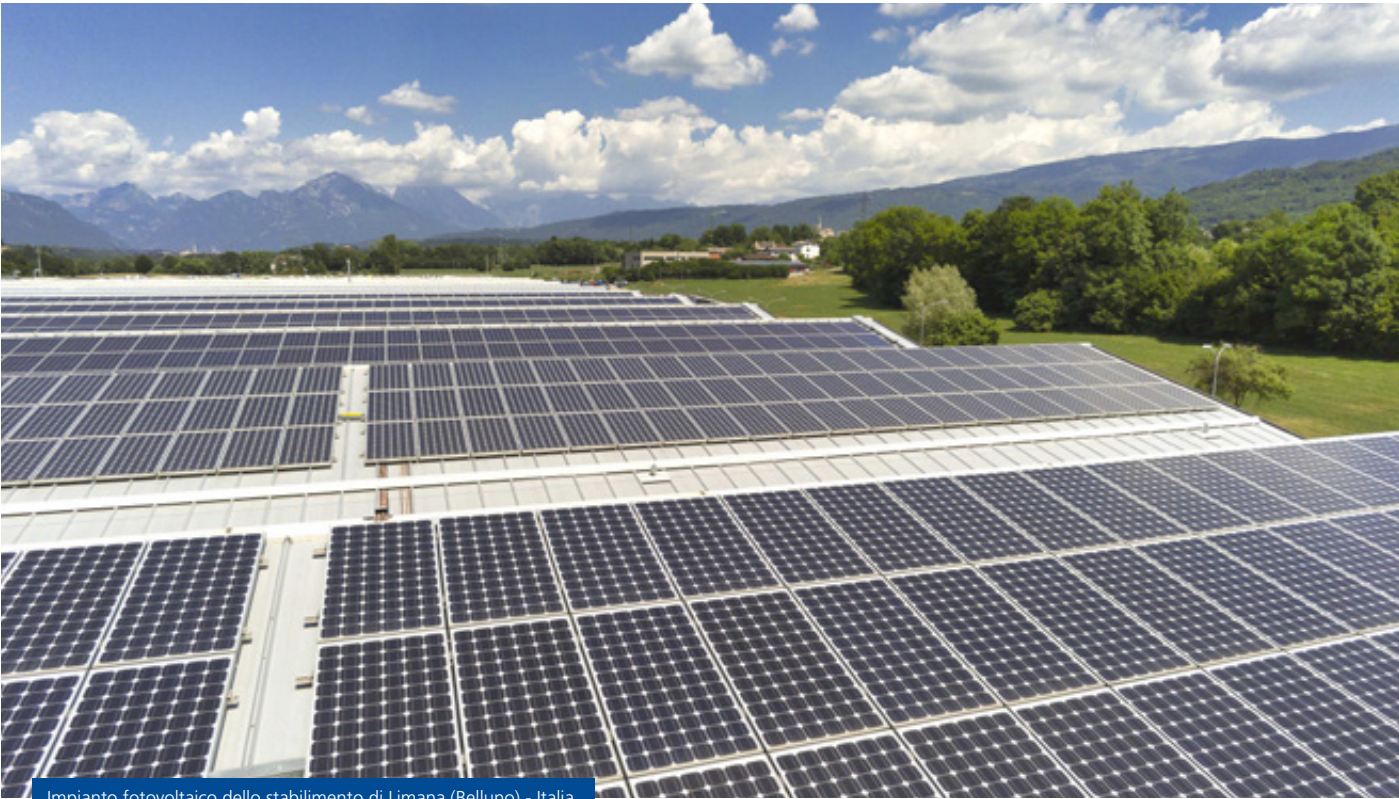
Impianto fotovoltaico dello stabilimento di Limana (Belluno) - Italia
