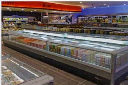
Die Tiefkühlabteilung des Edeka-Marktes besteht aus insgesamt fünf Tiefkühlblöcken
